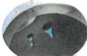
ハンドホール内部/通線前 漏水
